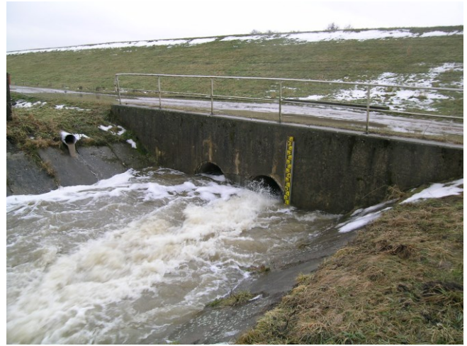
Foto 2: Auslaufbauwerk beim HW 2006
